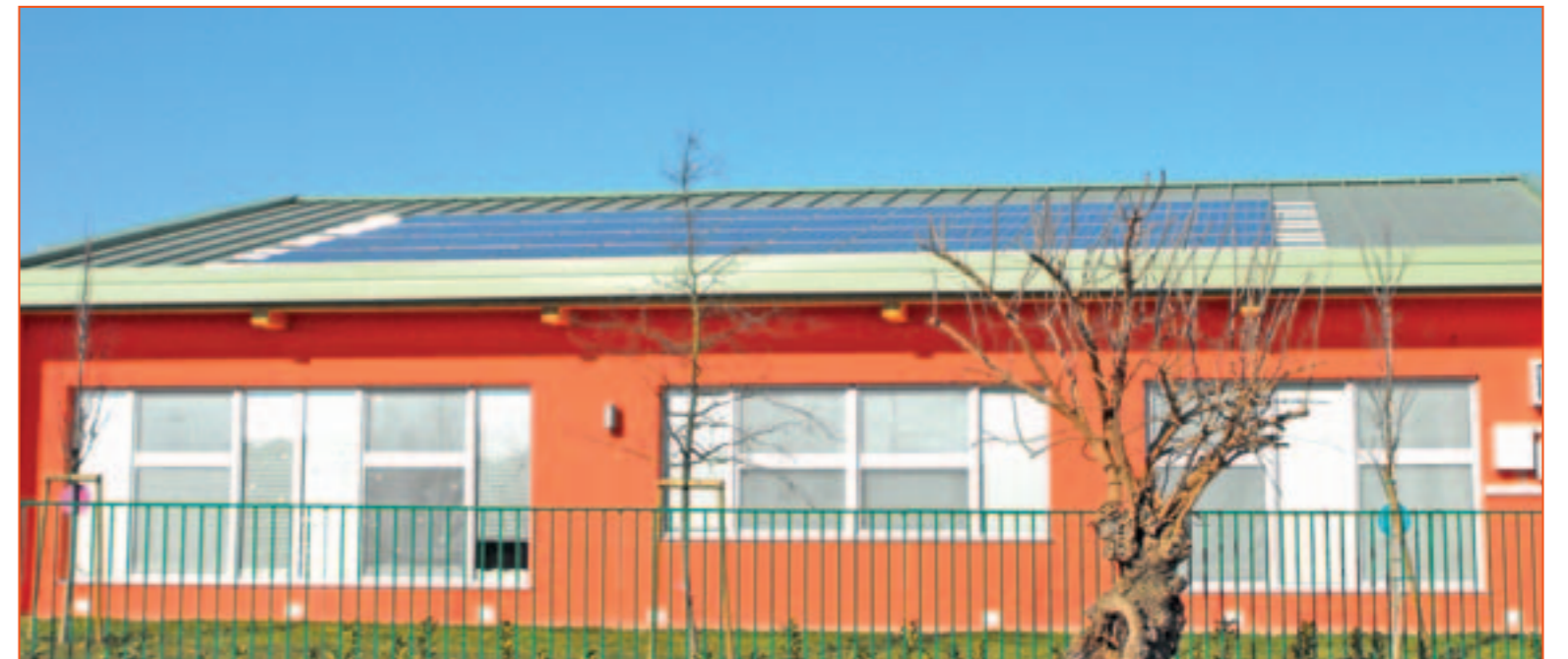
Il nuovo impianto fotovoltaico della scuola materna
